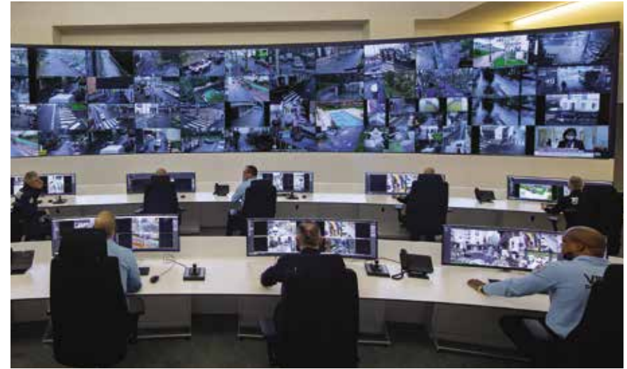
Le Centre de Commandement et de Supervision Urbain
